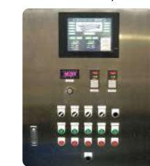
操作盤(タッチパネル)
