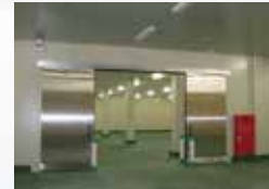
■ 自動冷蔵・冷凍庫
