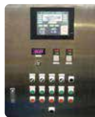
Панель оператора (сенсорная панель)
