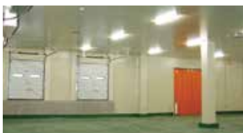
大型プレハブ冷蔵・冷凍庫
